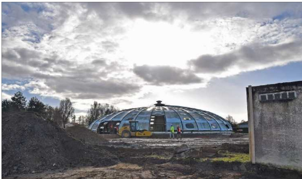
Les travaux de nivellement du sol tout autour de la coupole ont démarré. Les terrassements des futurs bâtiments vont suivre.
